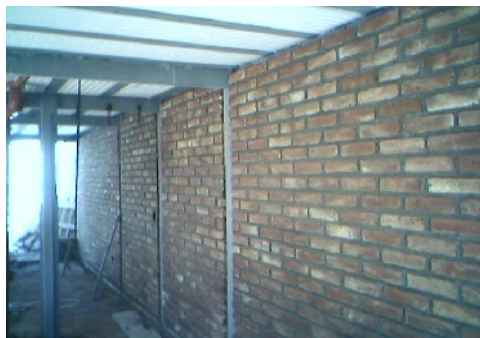
Estructura con solución de nudo metálico y cerramientos tradicionales (mampostería de ladrillo)
